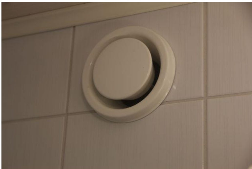
Kuva 19: Poistoilmaventtiili (KUVA: Toni Koski 2016)
