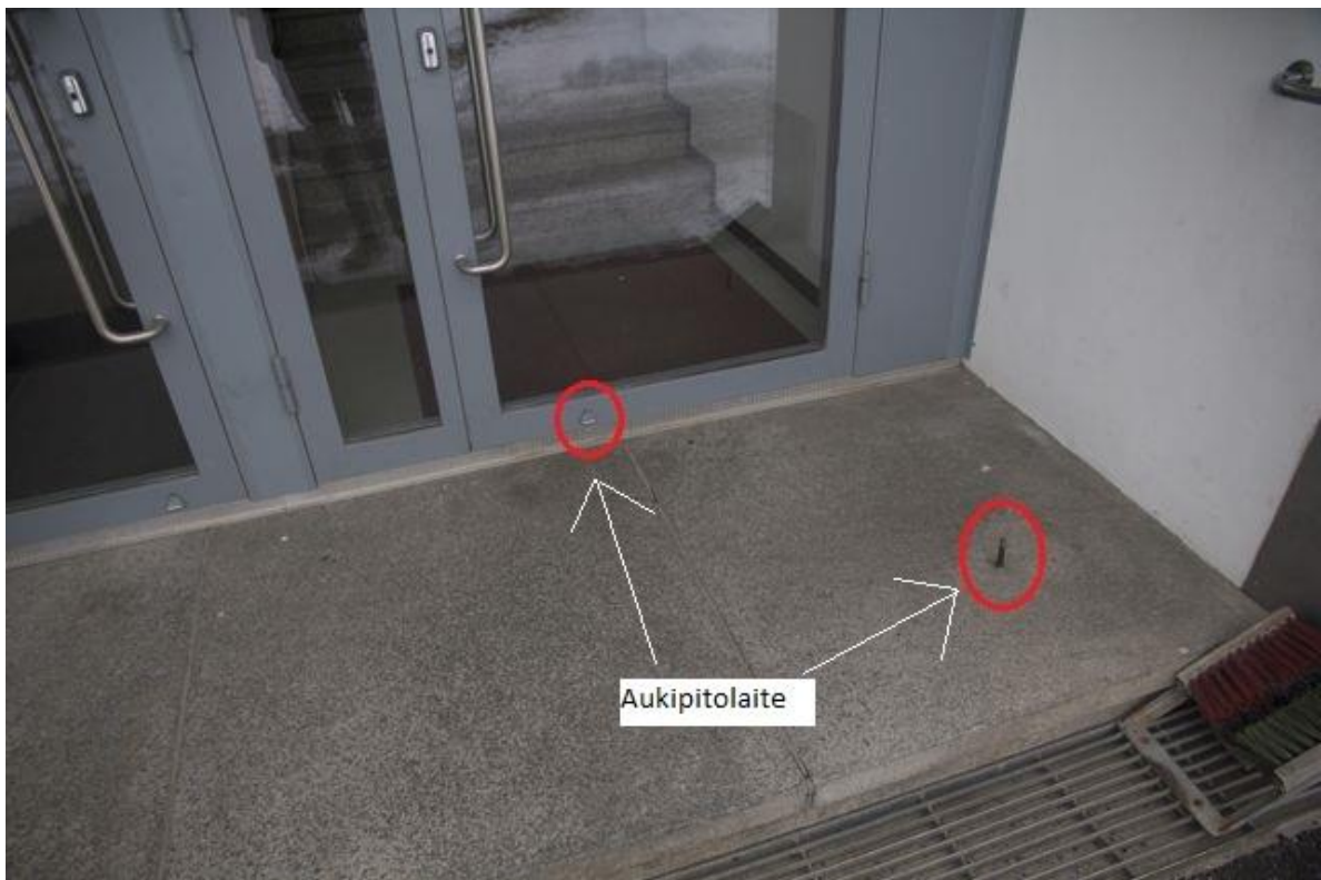
KUVA 1: Ulko-oven aukipitolaite (KUVA: Toni Koski 2016)
