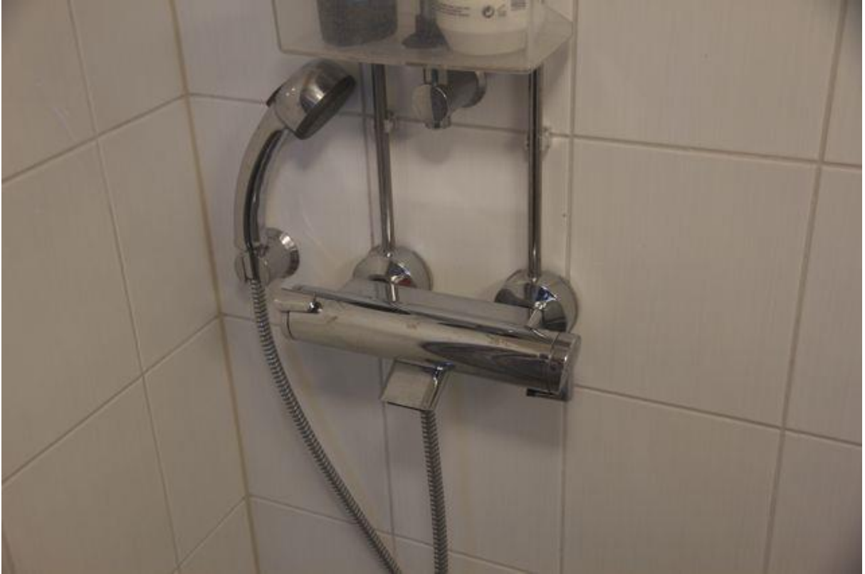
Kuva 16: Kylpyhuoneen termostaattisekoittaja (KUVA: Toni Koski 2016)
