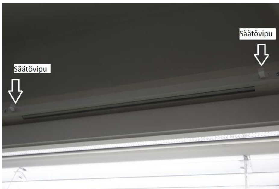
KUVA 11: Korvausilmaventtiili (KUVA: Toni Koski 2016)
