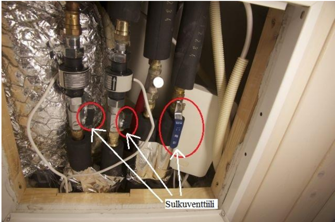
Kuva 18: Sulkuventtiilit (KUVA: Toni Koski 2016)
