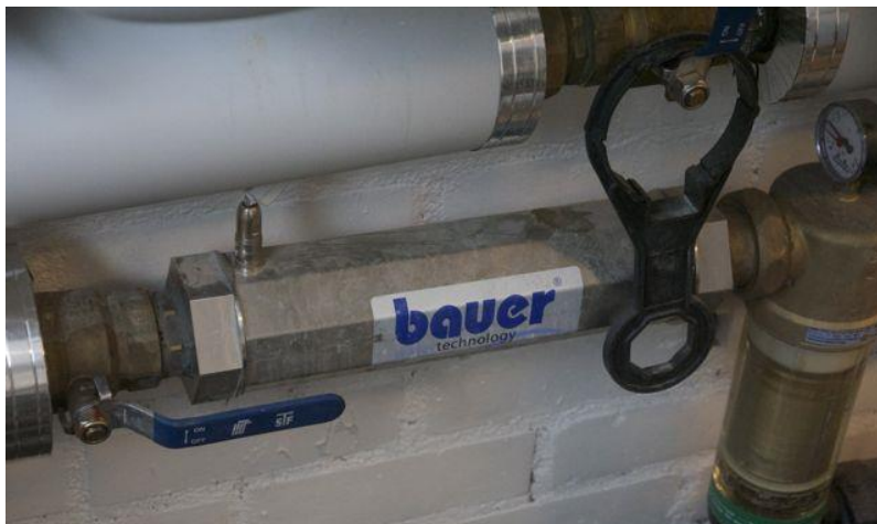
Kuva 17: Bauer Pipejet- vedenkäsittelylaite (KUVA: Toni Koski 2016)
