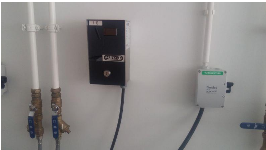
KUVA 5: Pesukoneen vesihanat, maksuautomaatti ja turvakytkin (vasemmalta oikealle) (KUVA: Toni Koski 2016)
