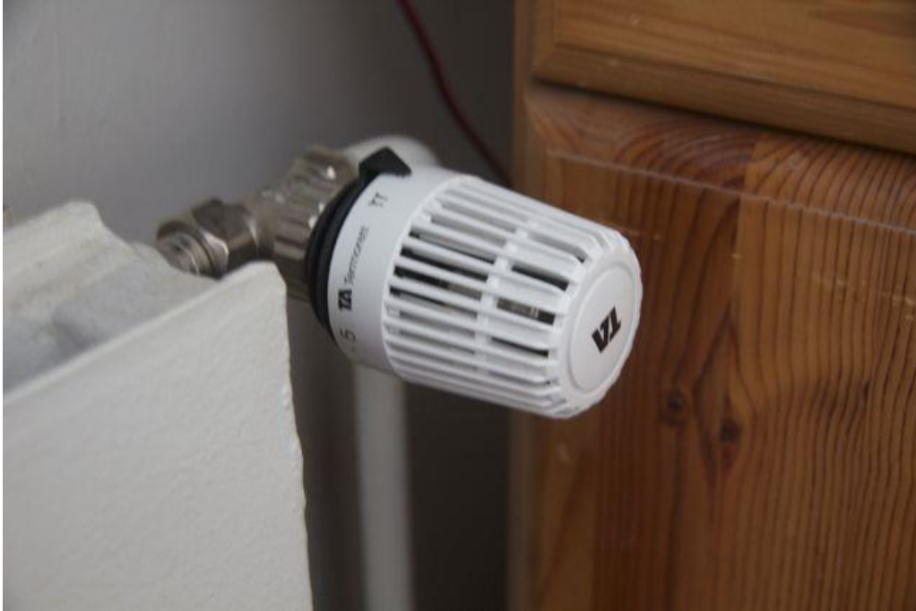
Kuva 14: Termostaattinen käsisäätöinen patteriventtiili (KUVA: Toni Koski 2016)
