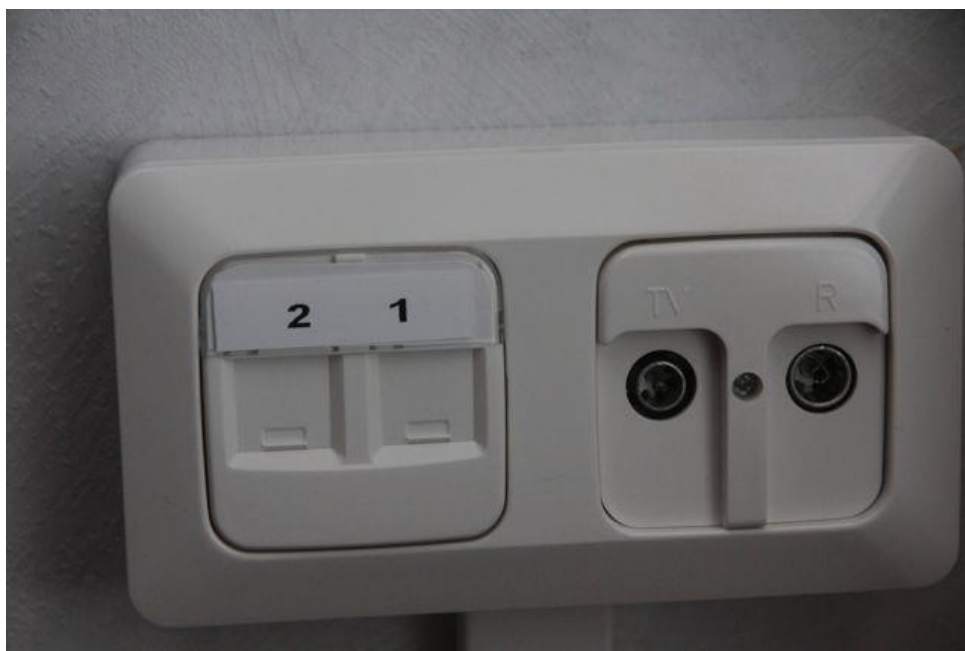
Kuva 25: Kaapeli- ja tietoliikennejärjestelmien pistokkeet (KUVA: Toni Koski 2016)
